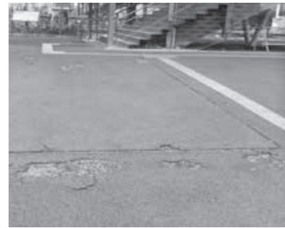
改修が望まれる路面
